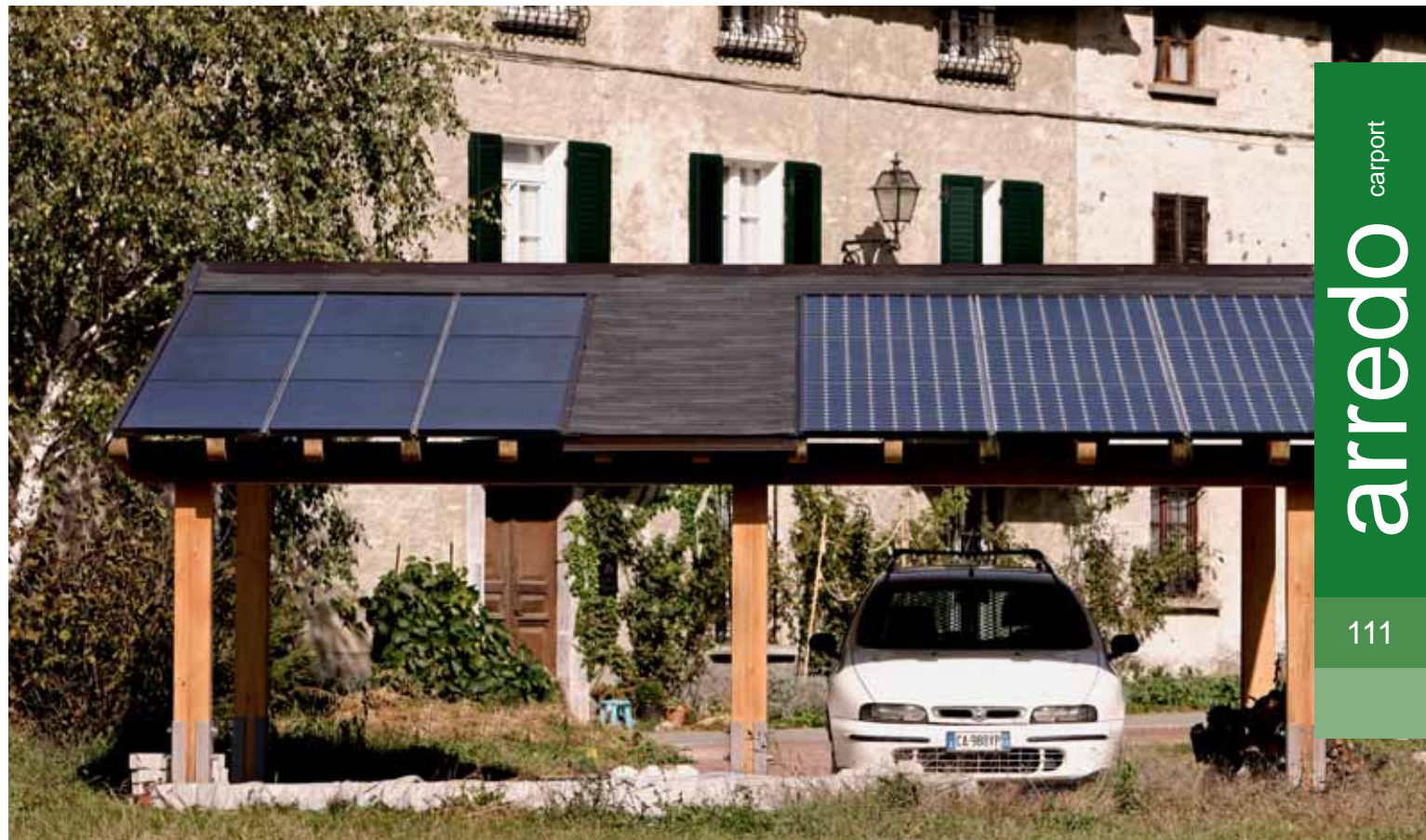
pannelli solari fotovoltaici forniti da: S.A.G.I. snc di Pini Gian Antonio & C.
